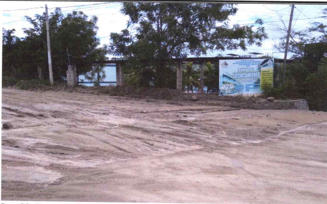
Foto 03: Se muestra la parte frontal cerco perimétrico existente, en malas condiciones de funcionalidad y estética.
